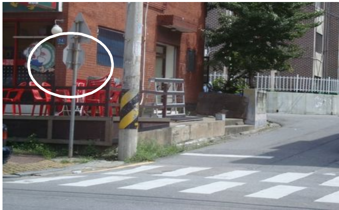
〈그림 3-23〉 방향이 틀리게 설치된 일시정지 안전표지 설치 사례 4
